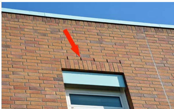
Abbildung 5: Gebäude mit Spalten in der Hinterlüftungsebene mit Quartieren der Zwergfledermaus (Roter Pfeil)
