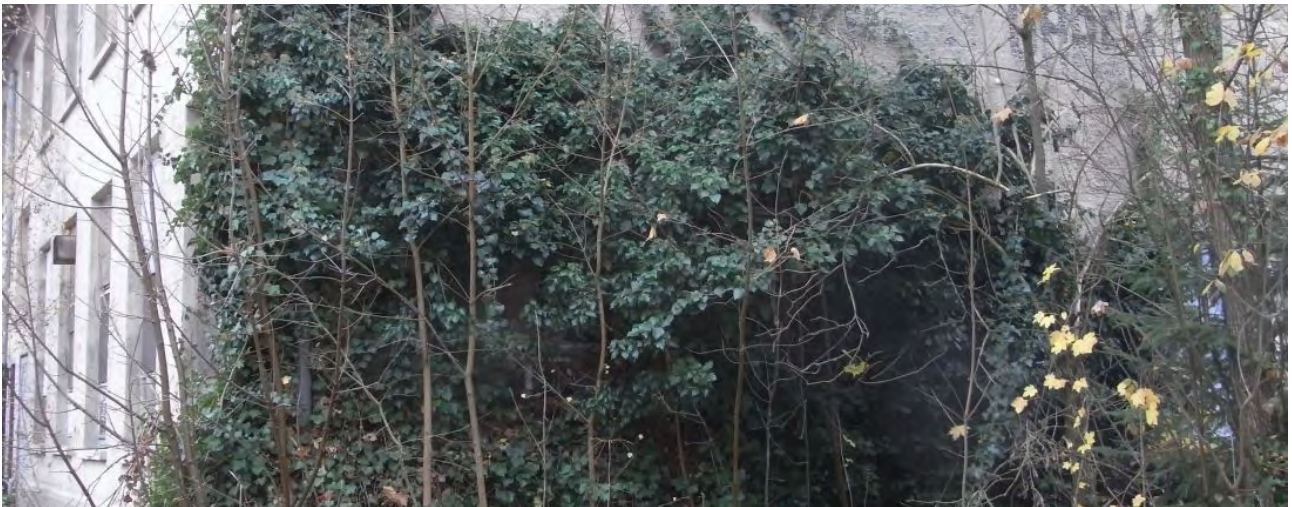
Abb. 9: Dichter Efeu als potenzieller Brutplatz an der Gebäudefassade.
